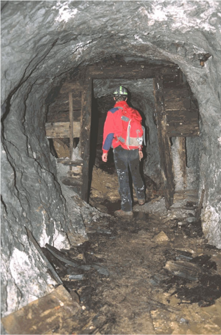
Abb. 15: Vermoderte Wettertüre im Hermann-Stollen.
